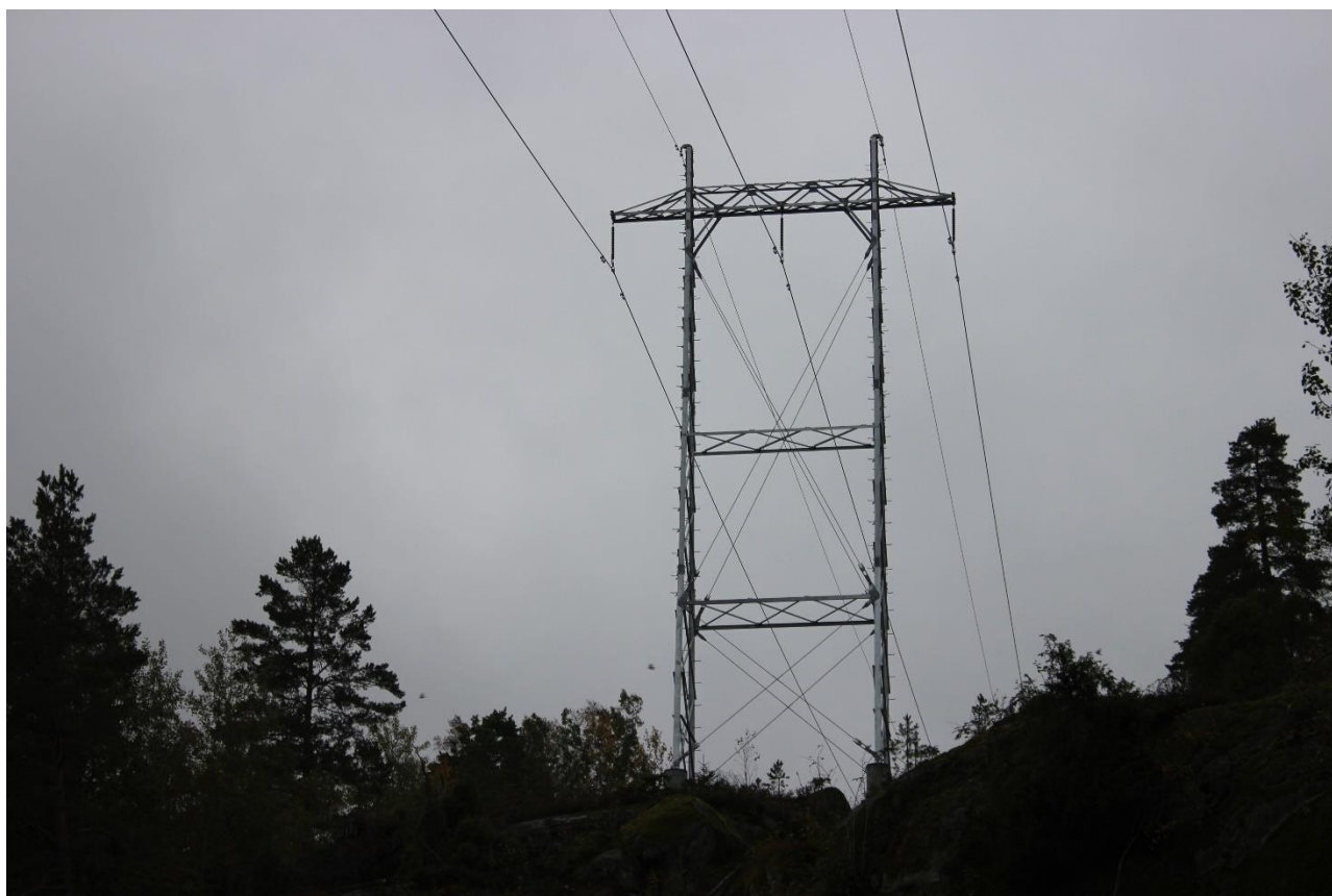
Figur 5-4. Bilde av portalmast i stål.
